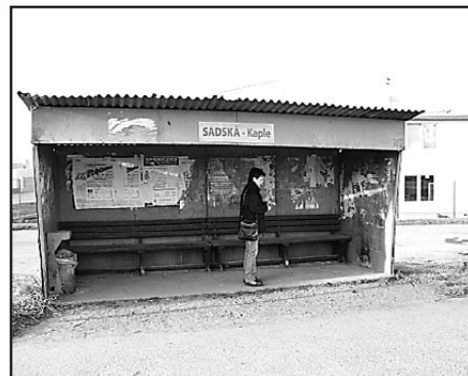
Na špatný stav autobusových zastávek opakovaně upozorňovali občané využívající autobusovou dopravu. Foto Tomáš Březina
